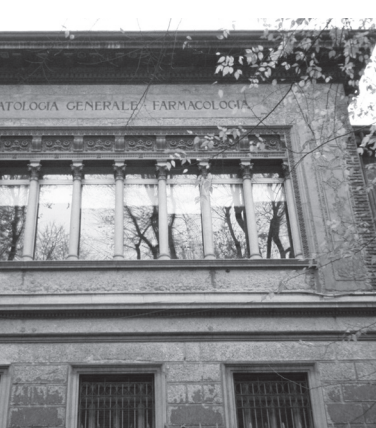
Evidenti segni di degrado sulla bella facciata dell'Istituto di Patologia Generale Farmacologia in via Mangiagalli
